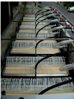
MBR 膜組裝置完成
